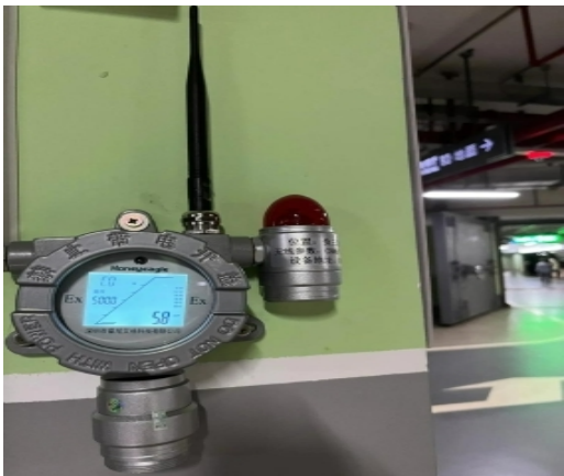
地下车库安装一氧化碳监控系统
